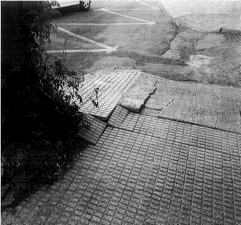
Avda. José Alegría, Zarandona, Murcia, bajada de acera para minusválido en mal estado que puede provocar accidentes y roturas de las losas.
