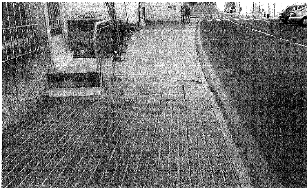
Avda. José Alegría nº 43, agujero en la acera y rotura de losas.
