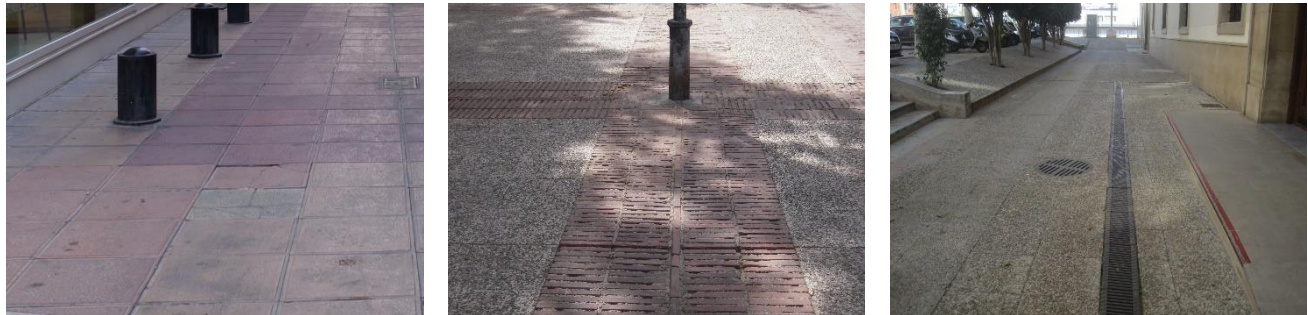
Pavimentos deteriorados en recorridos peatonales
