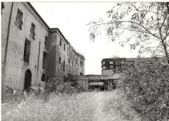
8.7. Alzado norte del Colegio. Vista hacia Callejón Burruezo. En primer plano a la izquierda se observa el volumen del inmueble que en la actualidad se conserva, adosado a éste, a su derecha vemos el cuerpo añadido y demolido en las obras de reforma de 1984. Hacia 1975
